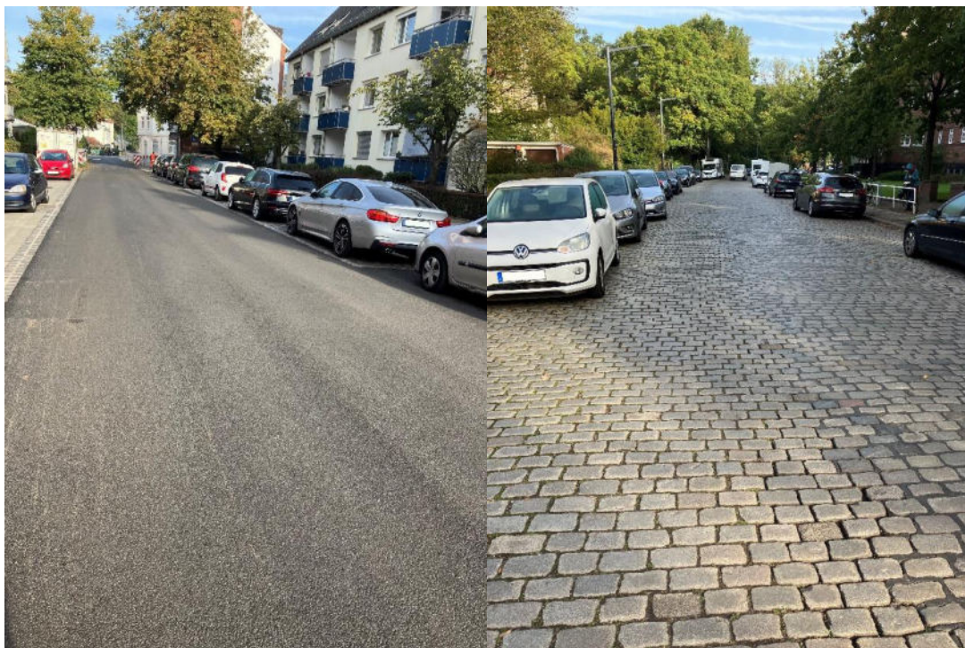
Abbildung 2: Bilder des bereits fertiggestellten 1. Bauabschnitts (BA) (links) und des noch nicht begonnenen 2. BA (rechts) in der Langen Reihe
